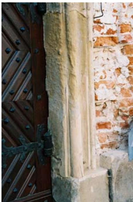
Węgar (fragment kamiennego portalu) po ok. 10 latach od nieprawidłowo przeprowadzonej konserwacji. Wykonano wtedy hydrofobizację bez usunięcia źródła zawilgocenia, co spowodowało przyspieszoną destrukcję piaskowcowego elementu
